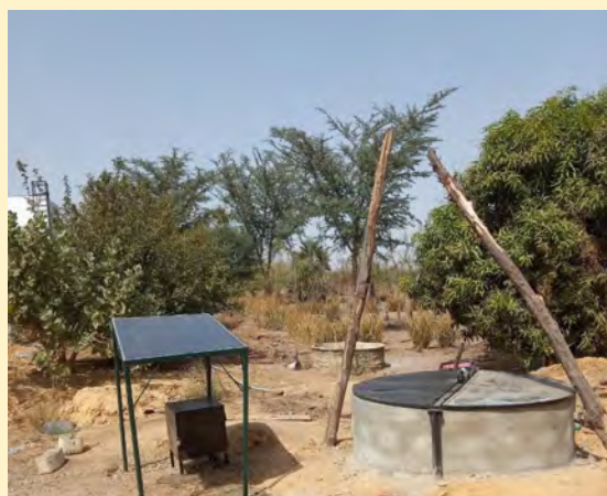
井戸とソーラーポンプ
