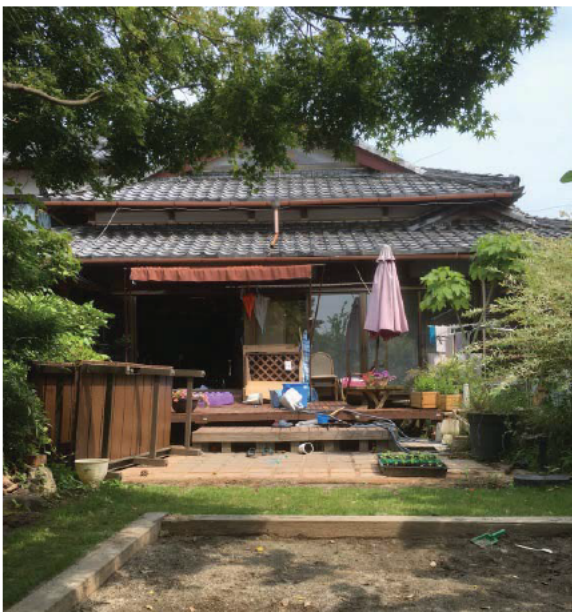
障害のある人も暮らす歴史ある住まいの、屋根の修繕工事を行いました(日野町)
